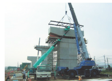
橋脚(柱部・梁部) 九州新幹線【熊本県】 SEEDフォーム(O)、製品厚:55mm
